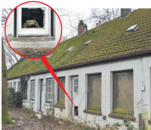
Trauriger Zustand trotz Denkmalschutz: Vandalen haben Fenster und Türen zertrümmert Foto: to
