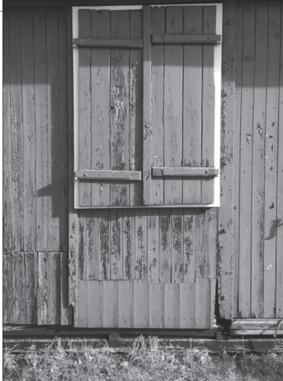
Schäden an der Fassade und den Fensterläden, 19.9.2019. Foto: Benno Finkelmeyer
